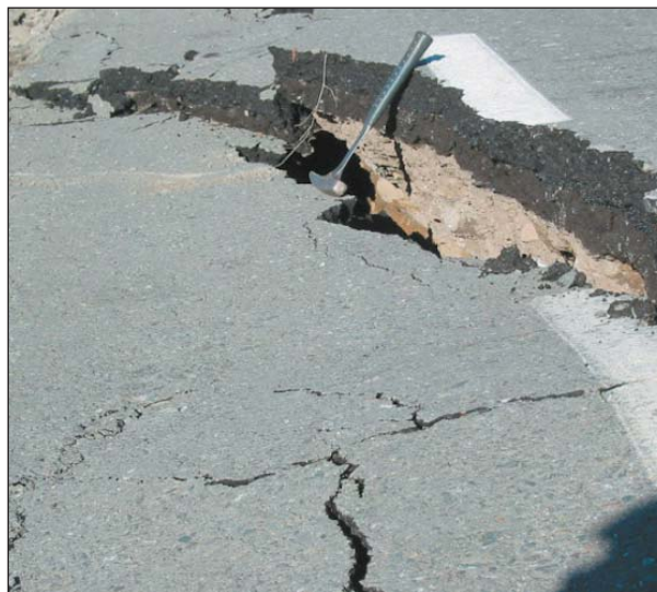
Сейсмогравитационные трещины в откосах земляного полотна Чуйского тракта, образовавшиеся после третьего сильного толчка (01.10.03, M = 6.9 ) в районе пос. Акташ в зоне 6-балльных сотрясений.
