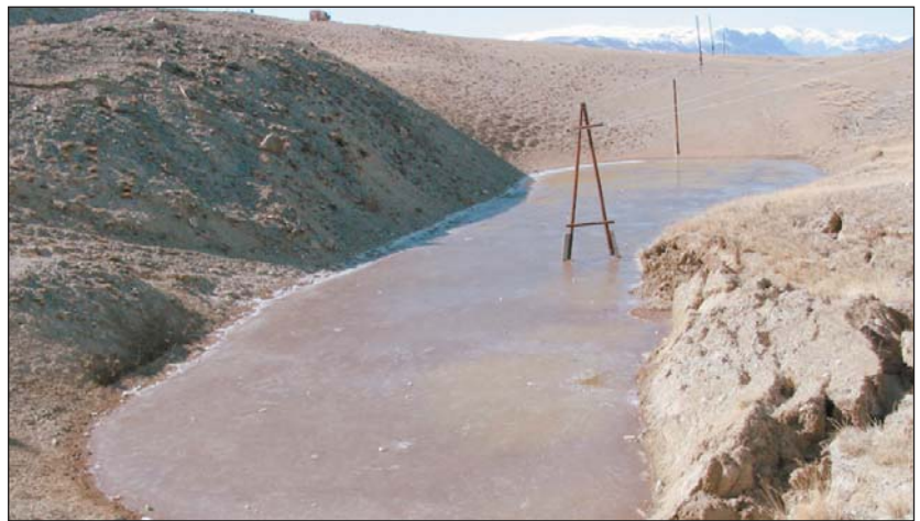
Геологические эффекты в зоне 8-балльных сотрясений на подъезде к пос. Бельтир. Вверху — оползень по откосу земляного полотна; внизу — просадки поверхности, заполненные излившимися грунтовыми водами.
